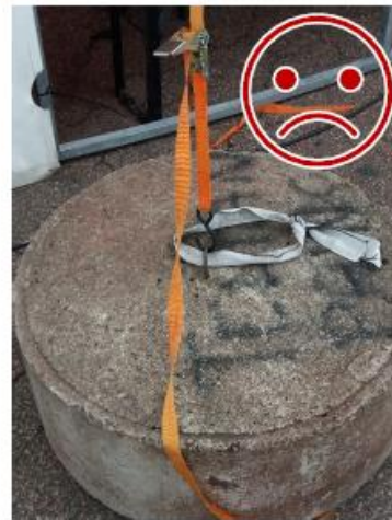
S-koukku irtoaa rakenteen jousaessa tuulella. Kiinnitystä ei ole lukittu kiinnityspisteeseen.
